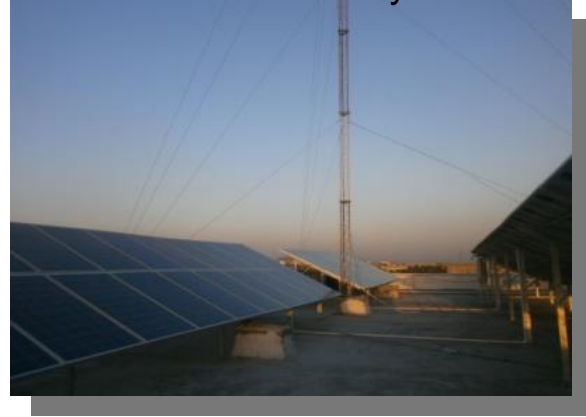
Solar PV Array
